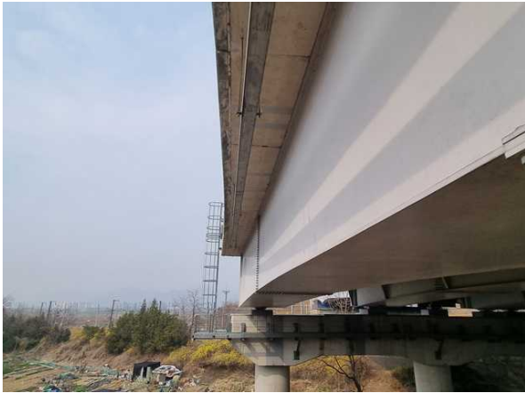
바닥관하면 S3 외측 캔틸레버 상태현황
