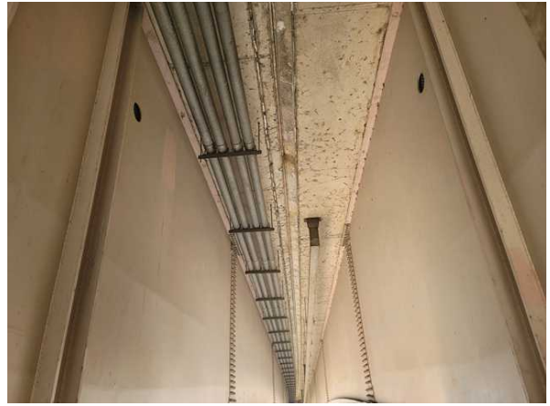
바닥판하면 S5 내측 캔틸레버 상태현황
