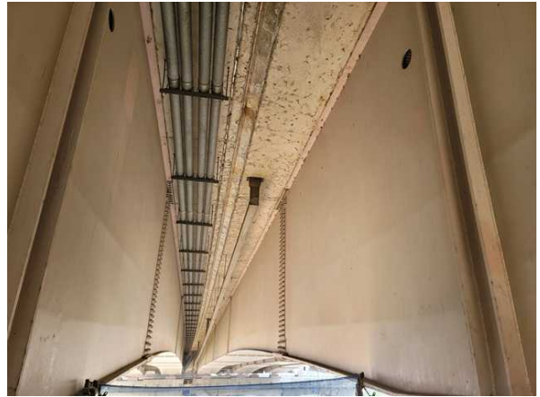
바닥관하면 S4 내측 캔틸레버 상태현황
